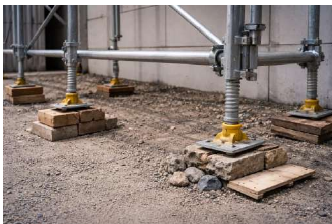
Sastatnes montētas uz nestabilas pamatnes
